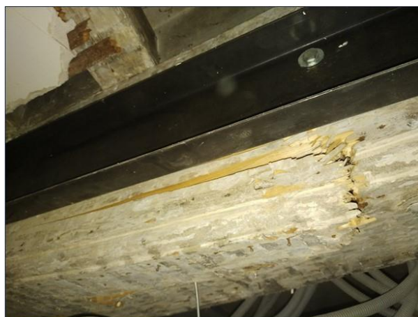
Fracture dans la poutre File C
