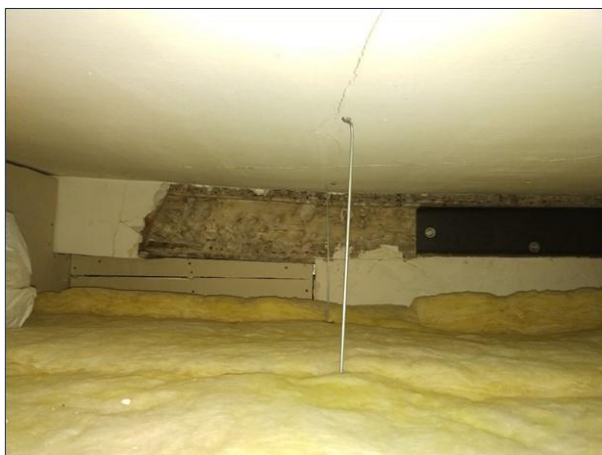
Présence d'un profilé métallique vissé sur une partie de la poutre File D
